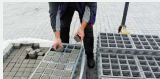
Zuerst auf der Baustelle die TTE®-Pflastersteine einstecken und dann verlegen. Mit Hubwagen die Paletten nachrücken.
